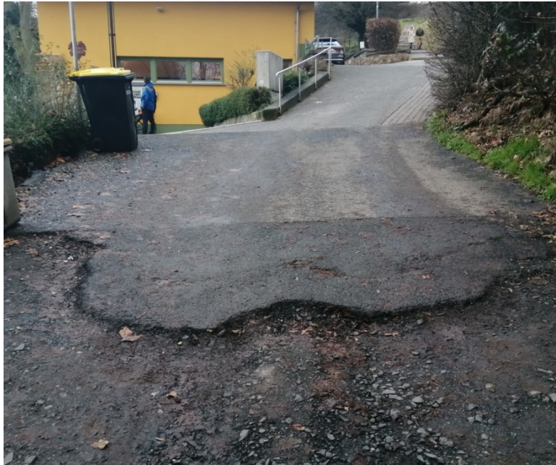
2020: Zufahrt zum Weinhaus in schlechtem Zustand
